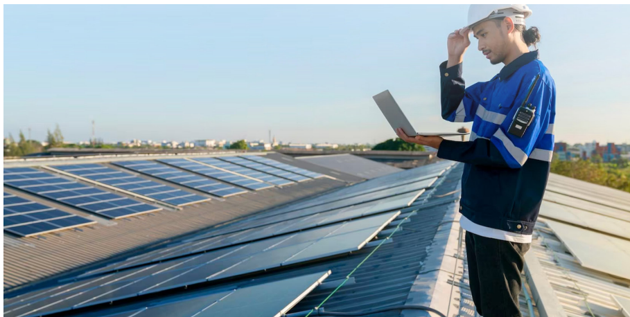
Zdjęcie 7: Instalacja fotowoltaiczna na dachu
